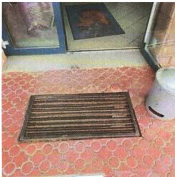
Zdjęcie nr 2: Metalowa kratka przed wejściem głównym. Widok z góry na fragment chodnika z widokiem na wpuszczoną w chodnik metalową kratkę.
