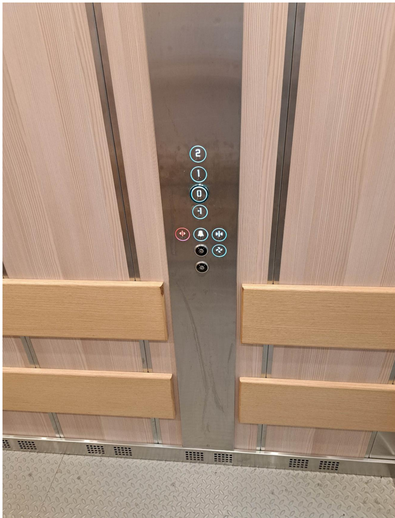
Komunikacja pionowa- winda- panel sterujący
